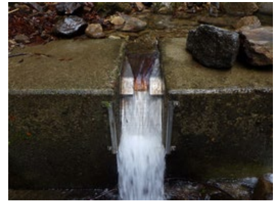
写真1 堰に設置された ステンレス製スクリーン (愛知県東栄町振草浄水場 水源地)
