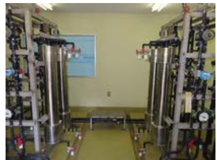
写真 4 猪古里浄水場膜ろ過施設
