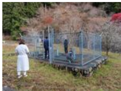
写真 7 牧野浄水場配水区域 第 2 減圧水槽
