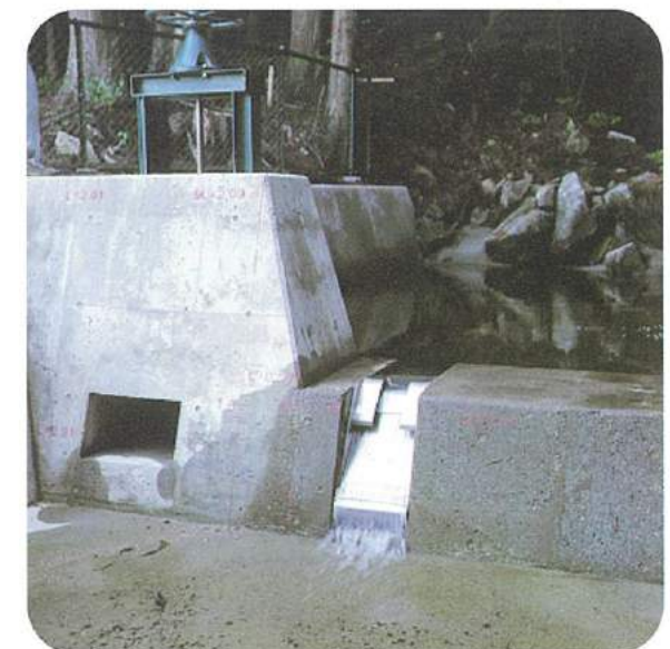
長野県内 2型 取水量200 m 3 /日
