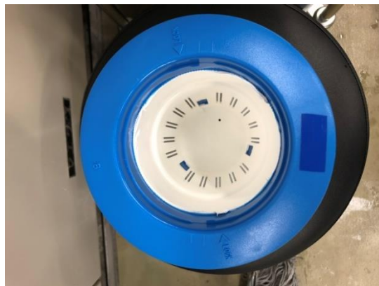
写真 2 塩素供給器（浮遊式）内部
