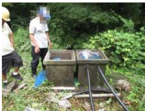
写真5 山根組水道組合 浄水処理施設
