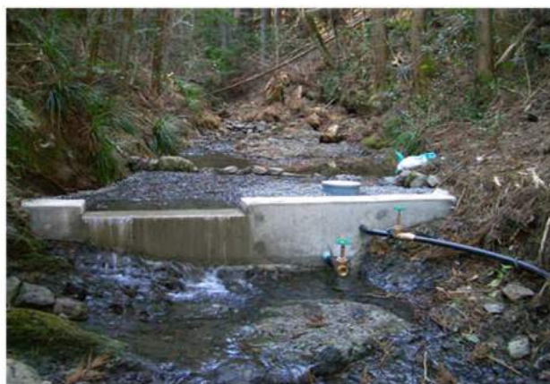
取水施設を整備し、浄水場へ送水
