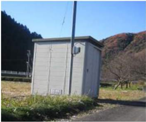
浄水場 (緩速ろ過池) (消毒装置)
