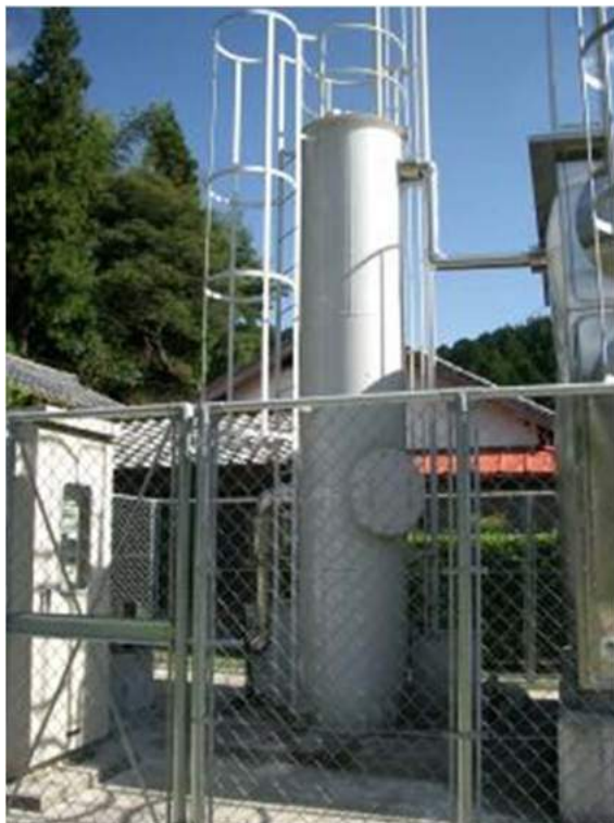
円筒形 急速ろ過池
