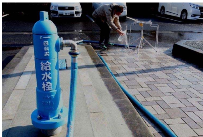
写真4 常設型の災害時用給水栓（写真提供：仙台市水道局）
