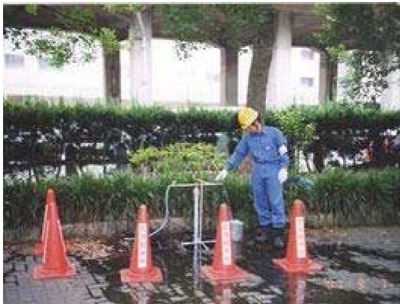
写真6 仮設給水栓（出典：名古屋市上下水道局ホームページ）
