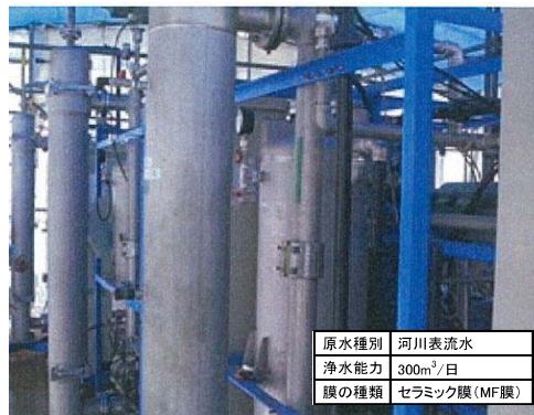
写真 26 仮設膜ろ過装置 (出典：写真 25 と同じ)
