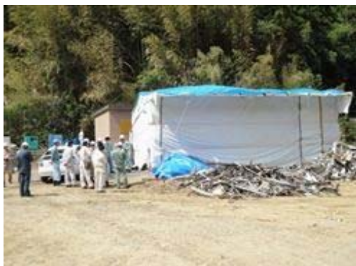
写真 25 仮設膜ろ過装置を収納したテント (出典：(財) 水道技術研究センター「東日本大震災浄水技術等支援チーム 現地調査報告書」(平成 23 年 7 月))
