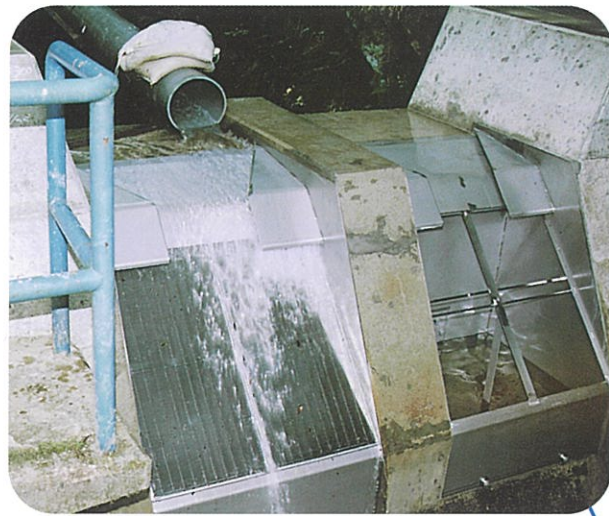
福井県内 7型 2台 取水量3000m 3 /日
