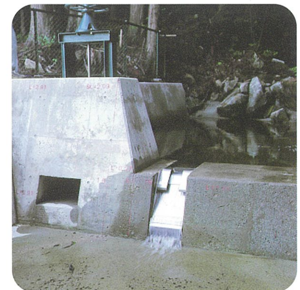
長野県内 2型 取水量200m 3 /日
