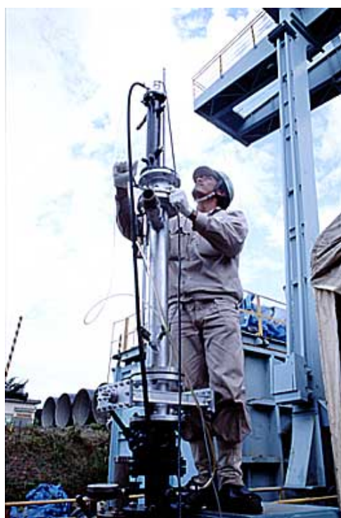
ロボット挿入・回収装置（試験管路にて）
