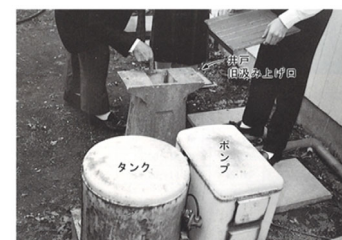
井戸等給水設備
