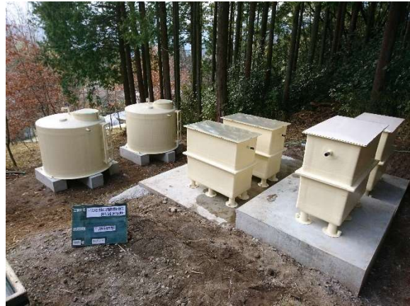
図 65 沈砂池 1 基，粗ろ過 1 基，緩速ろ過 2 基 寒冷地仕様断熱 FRP 製配水池 2 トン 2 基 2 世帯，6 人 1.8m 3 /日（別府市 T 地区）
