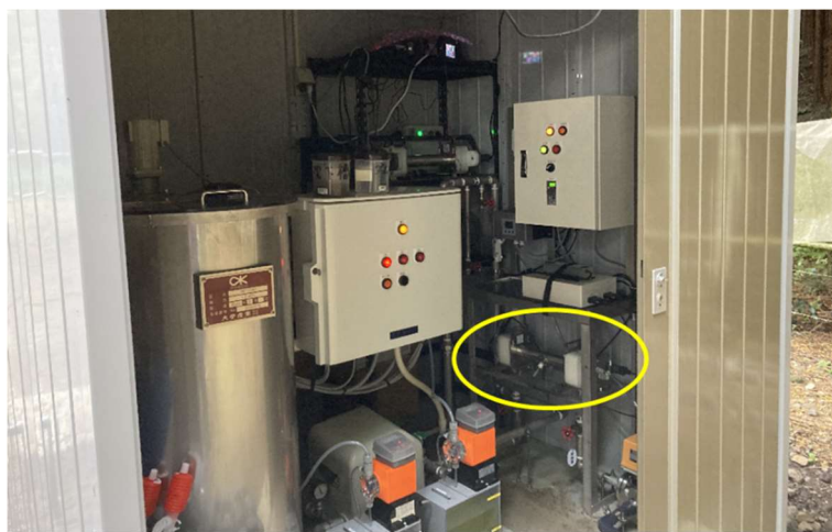
図 7. 集落水道における UV-LED 消毒装置導入例－1
