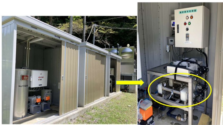
図 8. 集落水道における UV-LED 消毒装置導入例－2
