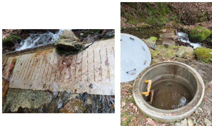
写真 2 大吉寺 スクリーンと原水槽
