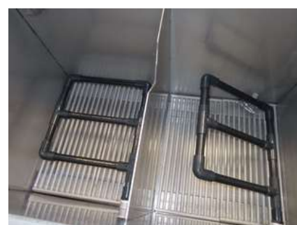
写真16 装置内の逆流洗浄管
