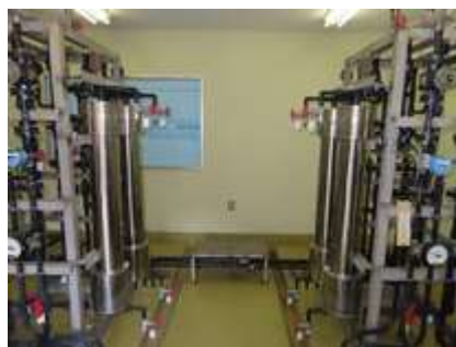
写真 5 猪古里浄水場膜ろ過施設
