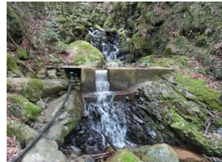
写真 19 表流水取水柵 （左手に導水管が見える）
