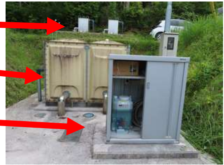
写真 18 配水池と塩素注入設備
