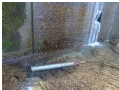
写真 6 ストレーナ付き集水管
