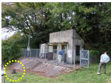
写真 25 竹之尾旧飲料水供給施設 深井戸
