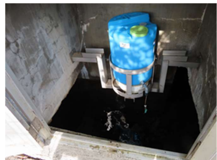
写真 3 大和合東村飲料水供給施設 配水池内の塩素注入装置
