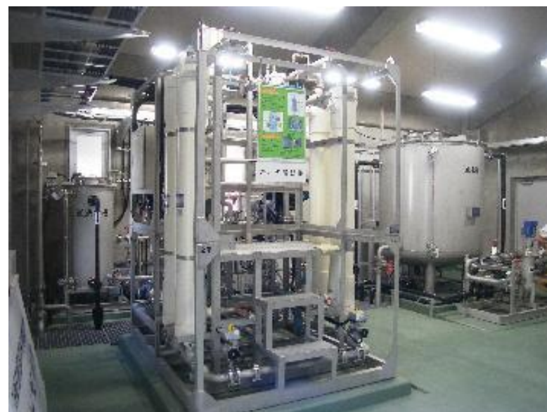
小規模水道施設の膜処理（京都市墨田地域水道）
