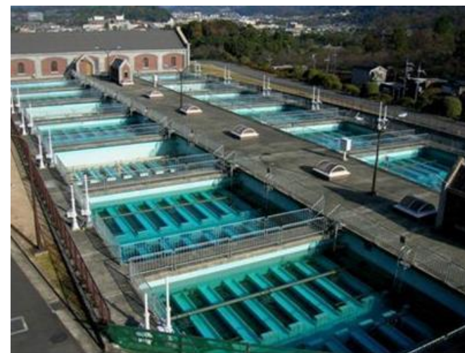
日本で最初に導入された急速ろ過浄水場 (京都市蹴上浄水場)
